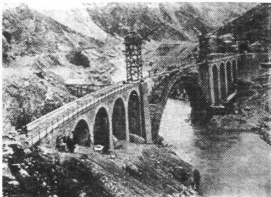
Εικ. 3. Γέφυρα υπό κατασκευή, έργο του Ιωάννη Μ. Ιωαννίδη (1937-8) [Μ. Γ. Γεωργιάδης, «Καρπάθιοι που τίμησαν την Κάρπαθο», εφ. «Καρπαθιακή Ηχώ», φ. 169 (Αύγουστος 1980)]
